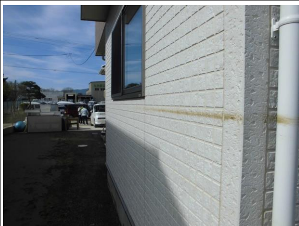
写真 3.1.14 外装材の浸水被害
