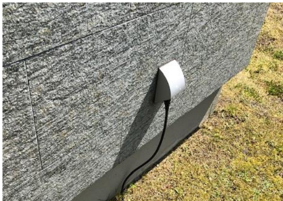
写真 3.2.13 外部コンセント
