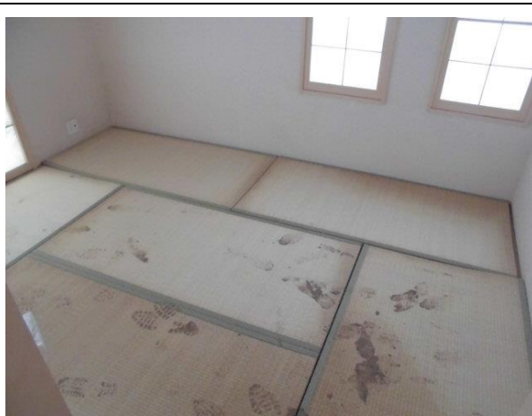
写真 3.1.6 和室の浸水被害
