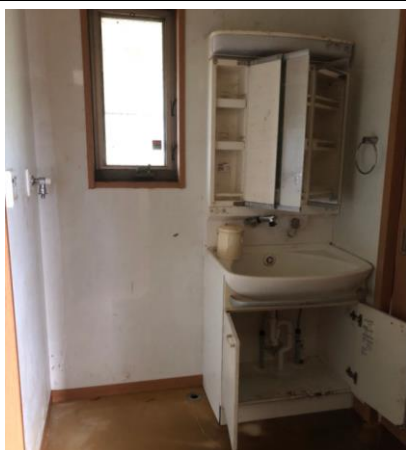
写真 3.1.13 住宅設備の浸水被害（洗面室）
