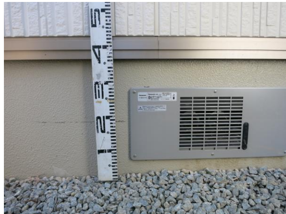
写真 3.2.2 基礎の床下換気扇
