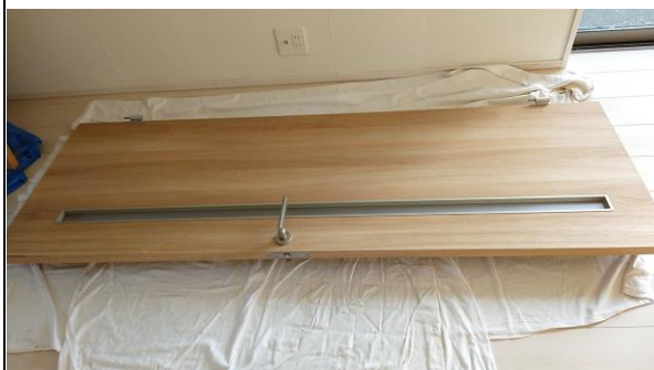
写真 3.1.10 内部建具の浸水被害
