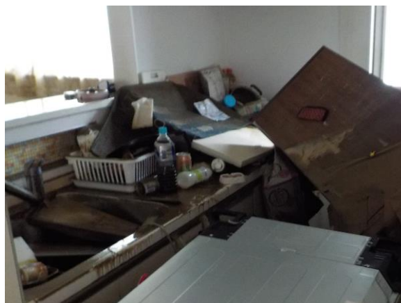
写真 3.1.12 住宅設備の浸水被害（キッチン）
