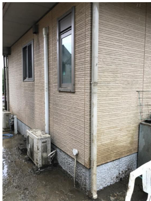
写真 3.1.17 外部部材の浸水被害
