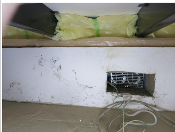
写真 3.1.1 床下の浸水被害
