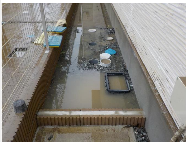
写真 3.1.4 外部配管の浸水被害
