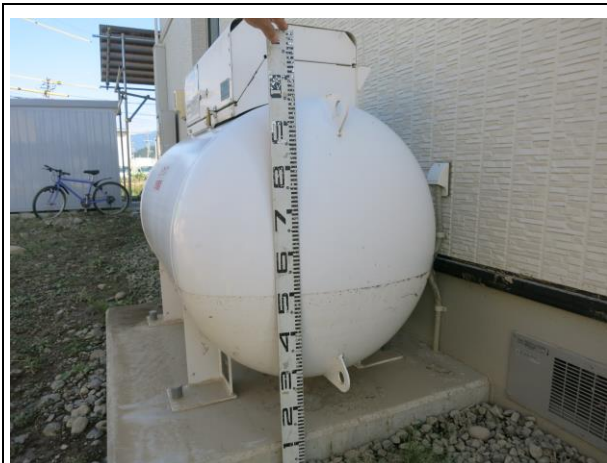
写真 3.1.3 屋外設備機器の浸水被害
