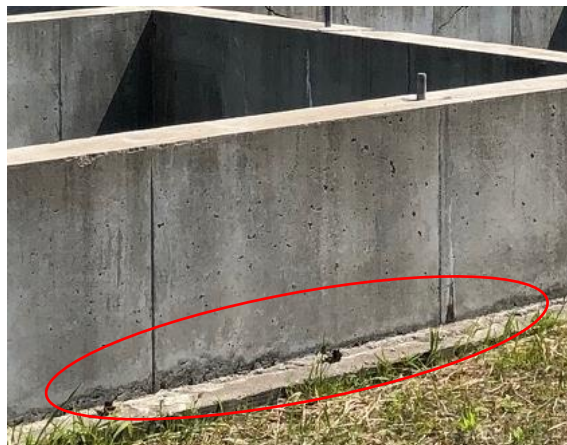
写真 3.2.16 コンクリートの打ち継ぎ部
