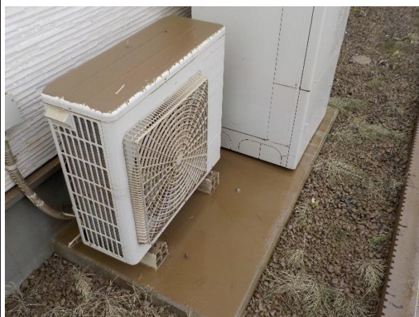
写真 3.1.2 屋外設備機器の浸水被害
