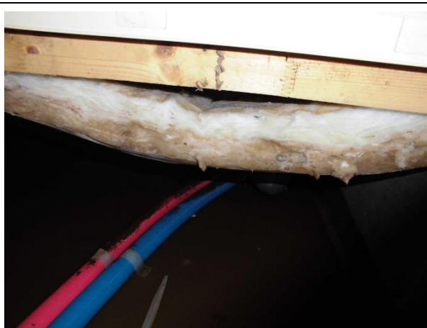
写真 3.1.5 床下断熱材の浸水被害
