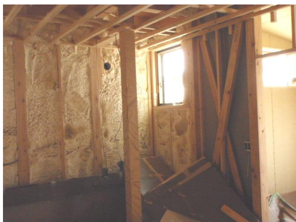
写真 3.1.9 外壁内部の断熱材の浸水被害
