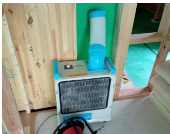
スポットクーラー屋内設置例
